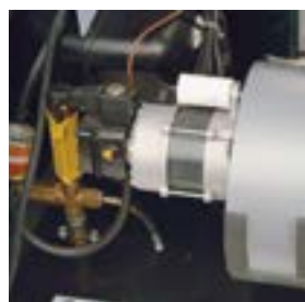
En-faset motor koblet til vifte og dieselpumpe.
